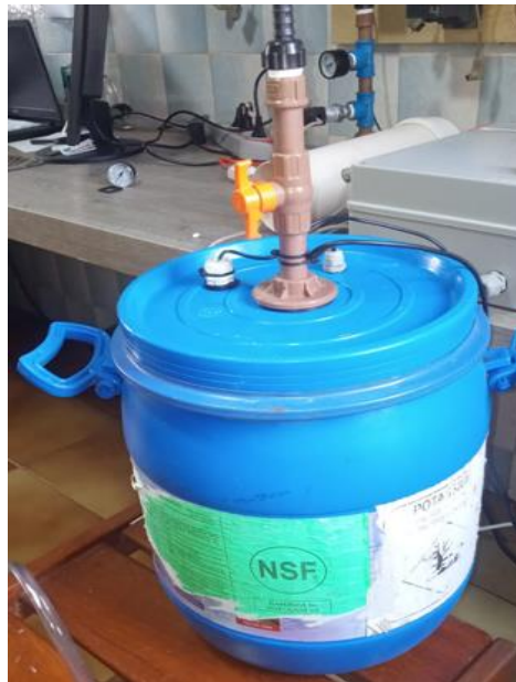
Figura 44 – Câmara do biodigestor
