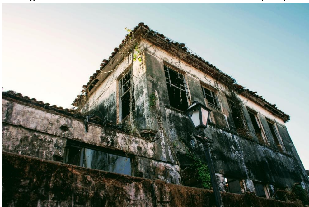
Figura 14 - Casarão em ruínas na Travessa do Portinho (2024)
