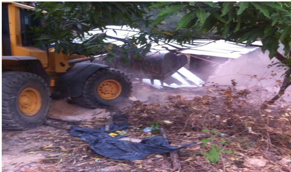
Imagem 09: Casa derrubada no Cajueiro no dia 18 de dezembro de 2014.
