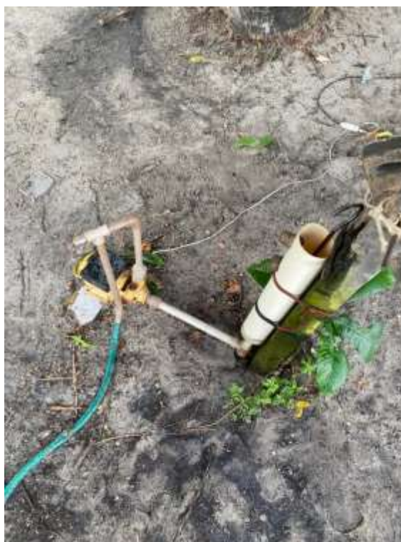
Figura 17: Bomba manual e elétrica - Casa 10
