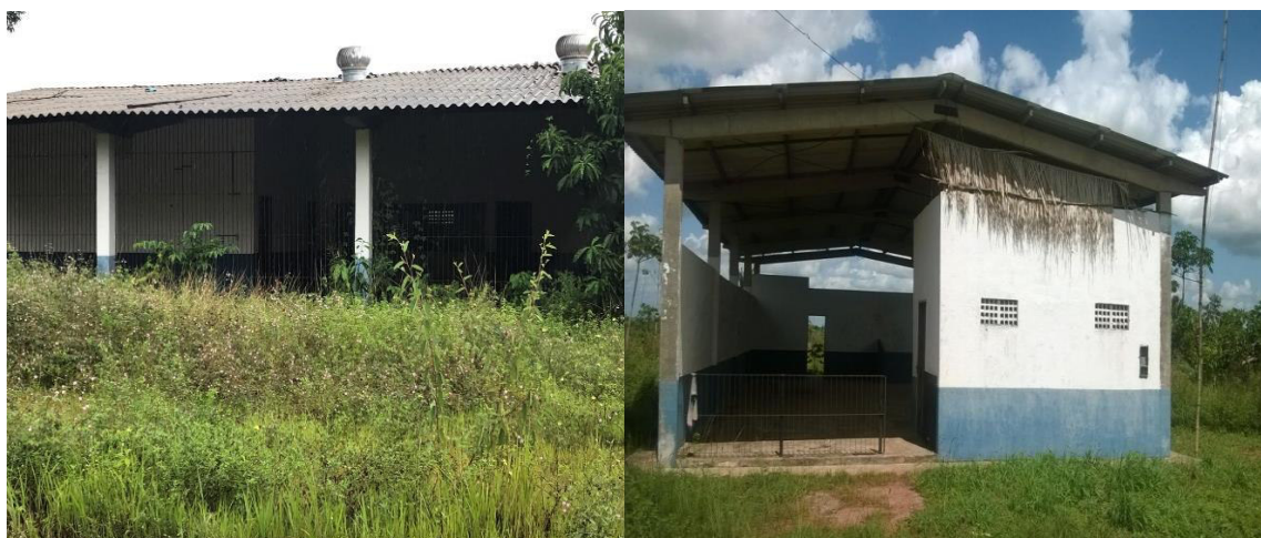
Figuras 37 e 38 – Casa de farinha construída no reassentamento Salva Terra I e Salva Terra II (Val Paraíso), sem funcionamento
