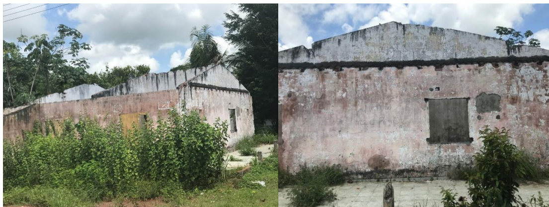
Figuras 31 e 32 – Fotos da residência do encarregado Ernesto no povoado de Santa Quitéria, após a tempestade
