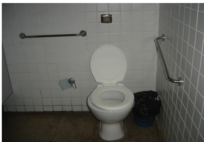
FIGURA 11 - Banheiro adaptado fora da norma no COLUN em 2006
