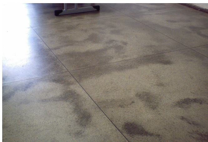
FIGURA 8 – Piso inadequado no COLUN em 2006
