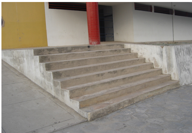
FIGURA 7 - Escada com ausência de corrimão no COLUN em 2006
