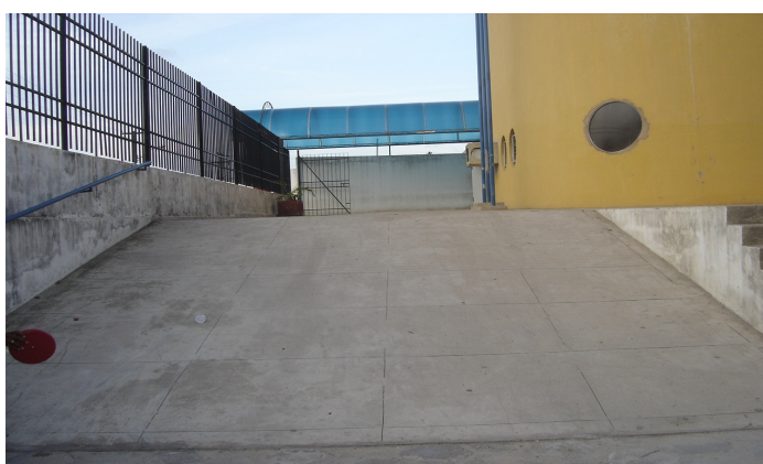
FIGURA 6 - Rampa acima da inclinação permitida no COLUN em 2006
